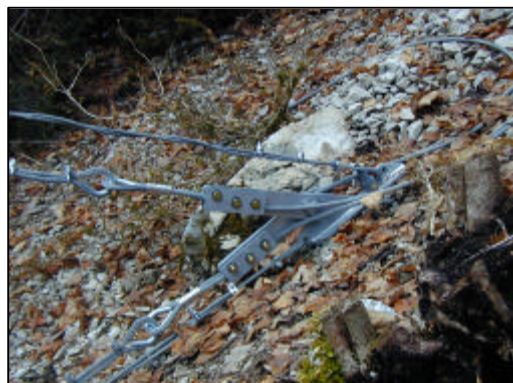
Bloc frein au niveau de l'ancrage amont
