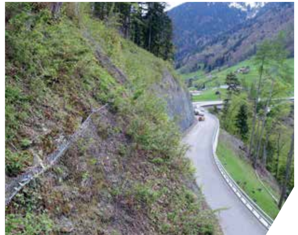
Grillage de protection contre les chutes de pierres (Ancrage du câble de bord)
